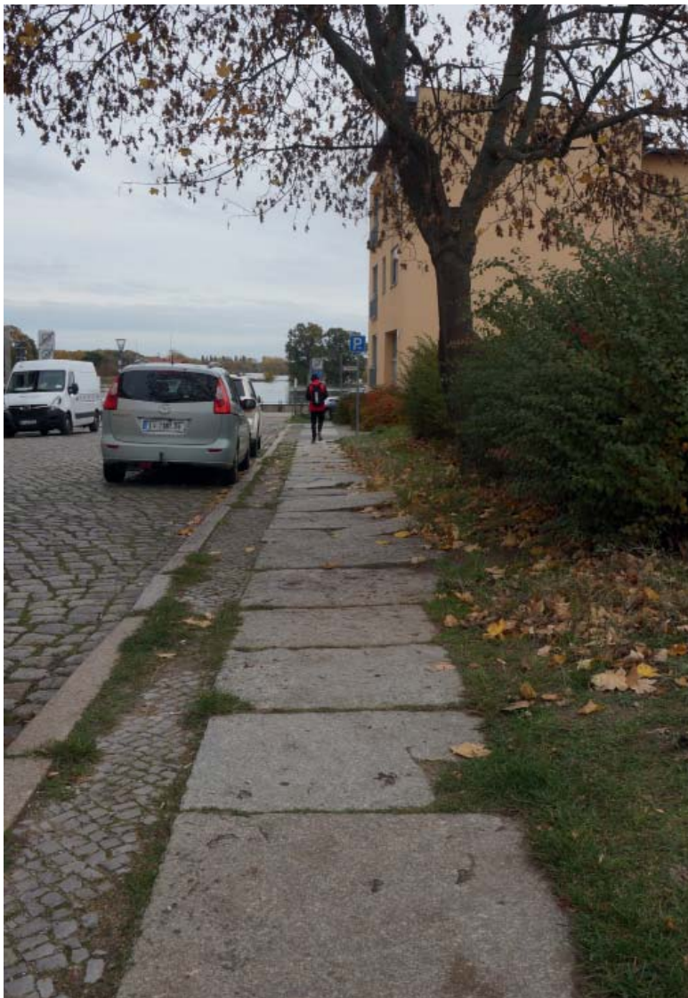
Der Gehweg in der Carl-Philipp-Emanuel-Bach-Straße ist eine Stolperstrecke
