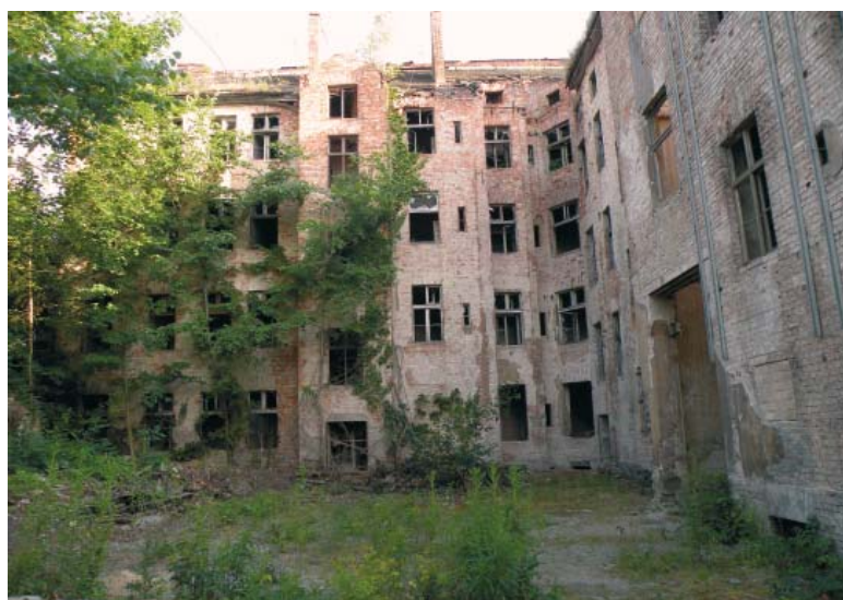
Berliner Straße 20/22 - Die Natur erobert sich das verfallene Gebäude zurück
