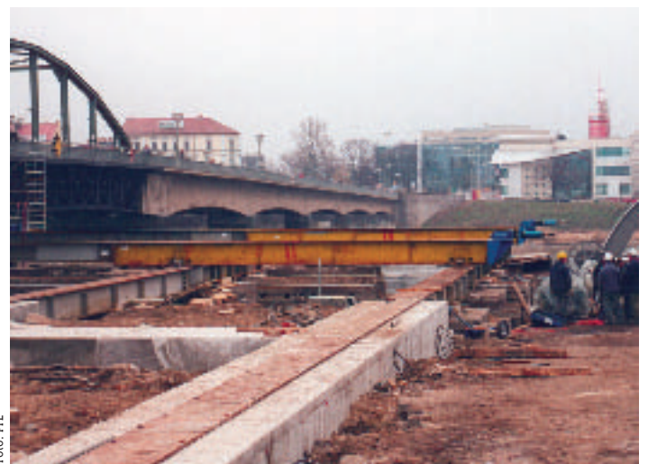
Vor wenigen Monaten – Die Anfänge des Brückenbaus der Behelfsbrücke über die Oder.
